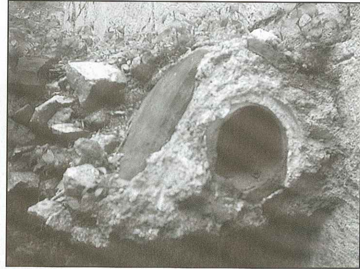
Resim 8: Ayasofya'nın kuzey bahçesindeki parçalanmış su boruları
